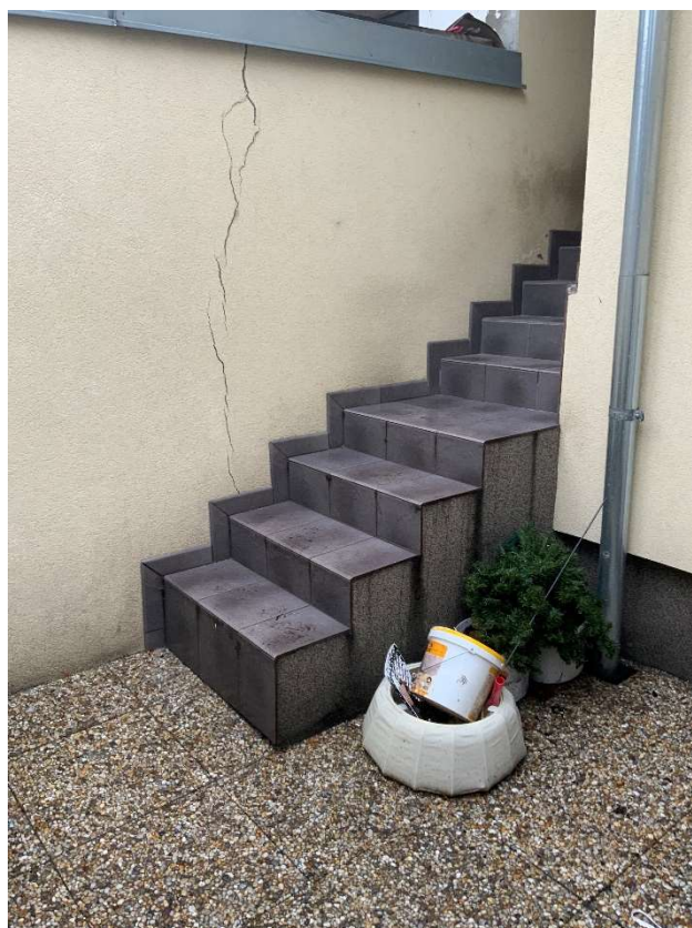
Trhlina v plotové stěně
