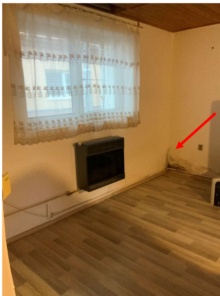
Plíseň v rohu místnosti u podlahy
