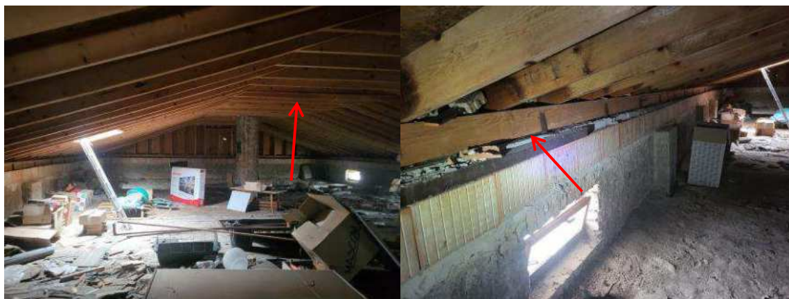
Obr. trhliny v pozednici
