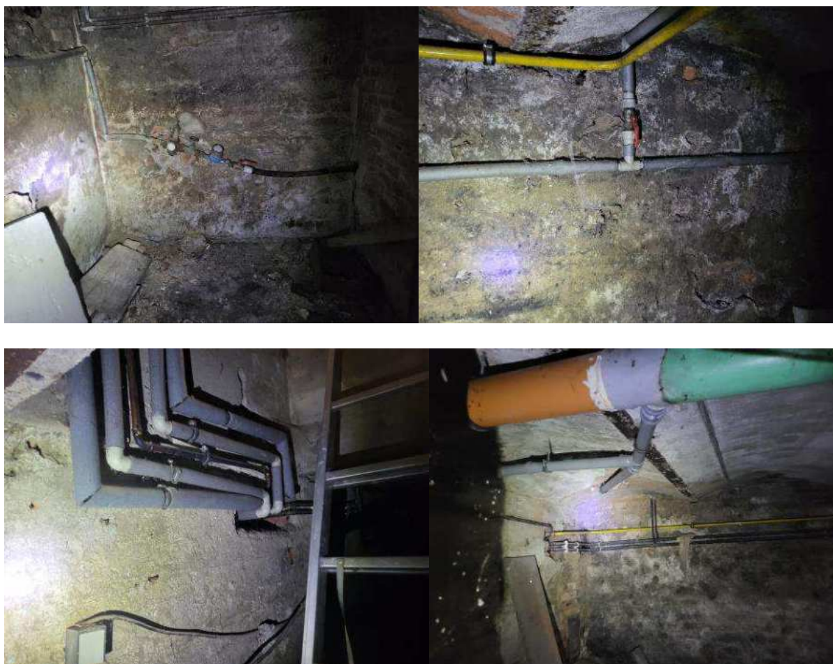
Obr. hlavní uzávěr vody, rozvody v suterénu
