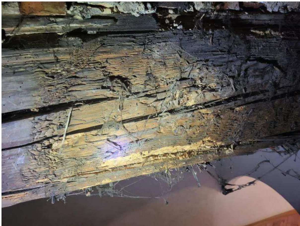
Obr. Stropní trémová konstrukce napadená dřevokazným hmyzem
