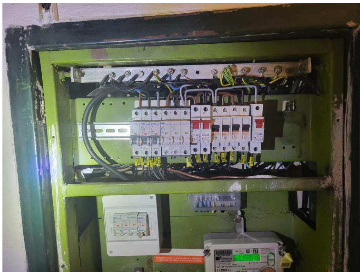
Obr. obnažené vodiče a přístroje v rozvaděči
