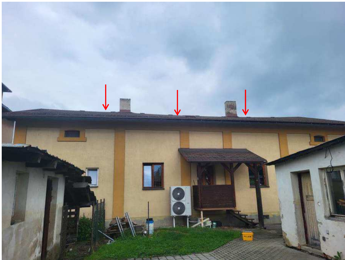
Obr. deformace střešní konstrukce, propadající se zvlněný hřeben střechy
