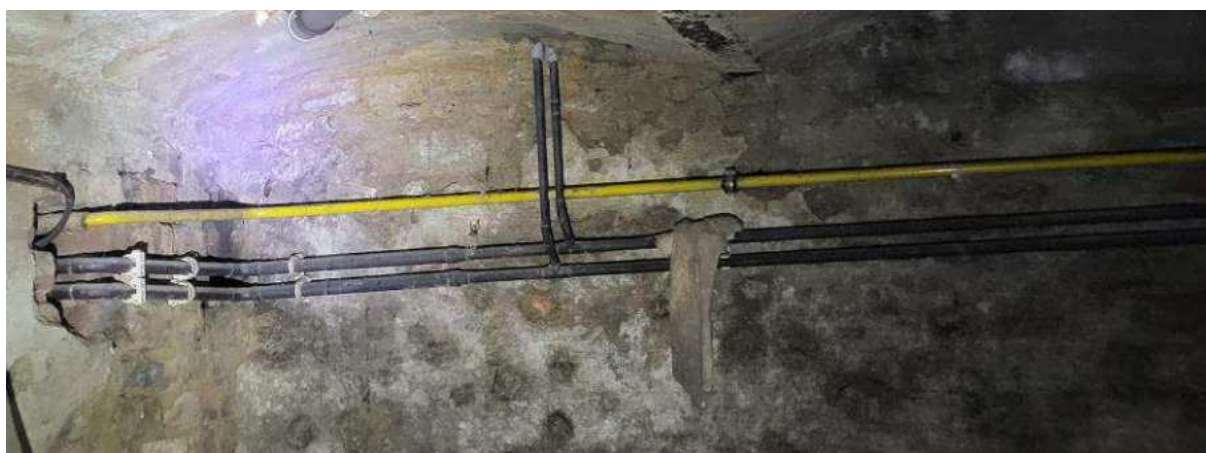
Obr. obnažené rozvody ÚT v suterénu
