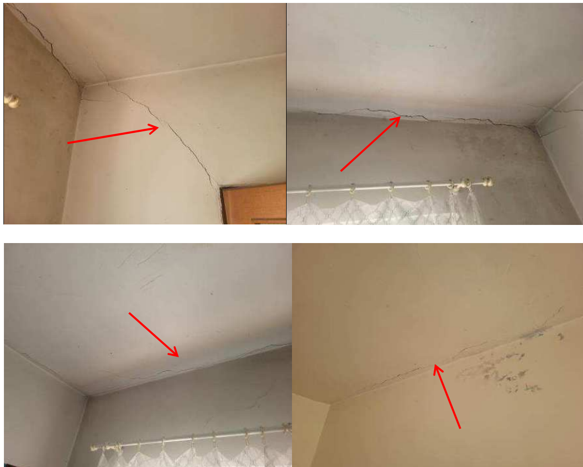
Obr. trhliny ve zdivu
